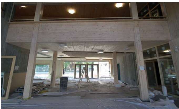
Ansicht des Foyerbereichs: Untergehängte Decke mit Würth Vollgewindeschrauben an den wandartigen Träger oberhalb der hinteren Stützenreihe
