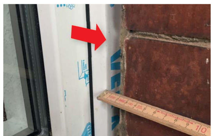
Bild 6: Fehlender Wetterschutz im Bereich der Laibung
