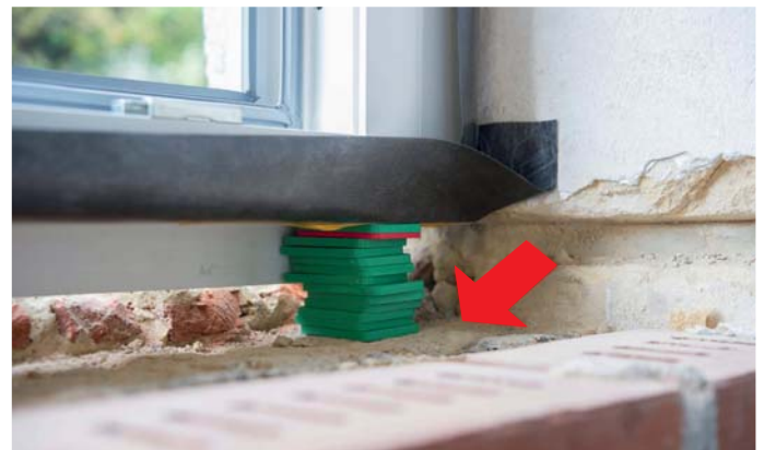
Bild 3: Mangelhaft vorbereiteter Untergrund im Bereich der Brüstung
