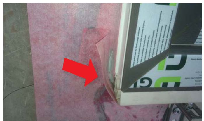
Bild 5: Abgelöste Folienabdichtung im Bereich eines Bankanschlussprofils
