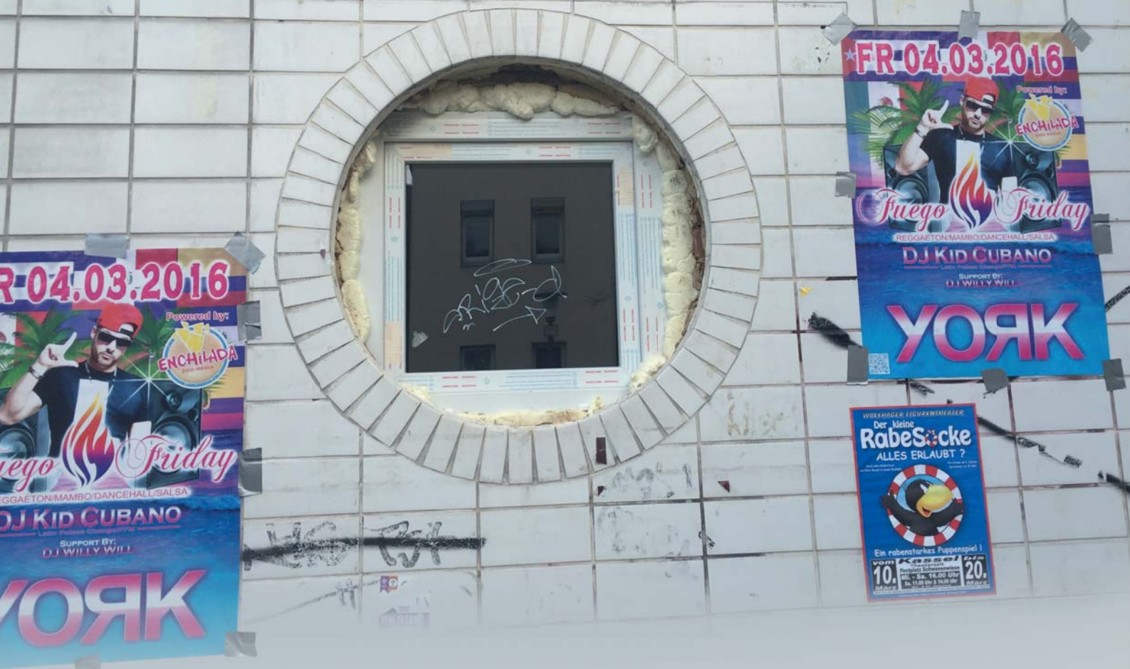
Bild 1: Fenster mit verbesserungsfähigem Wetterschutz
