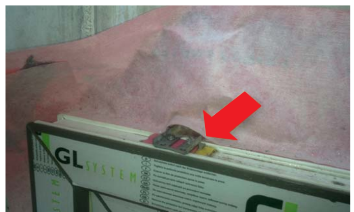
Bild 4: Unzureichend abgedichtete Durchdringung der Luftdichtheitsebene
