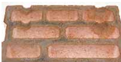
Bild 17. Ausbrechen der Stege in einem Lochziegelstein (links Drehbohren, rechts Hammerbohren)
