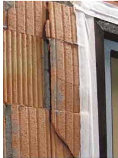
Bild 15. Steinausbruch beim Sicherheitsversuch mit ca. 2800 Pa und einem Randabstand von nur 5 cm [14]
