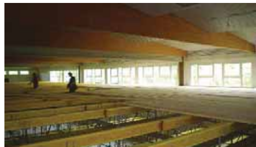
Bild 3. Raumgerüst als Standgerüst mit flächenorientierten Gerüstlagen
