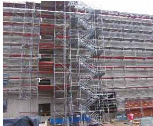
Bild 1. Rahmengerüst als Standgerüst mit längenorientierten Gerüstlagen (Fassadengerüst)
