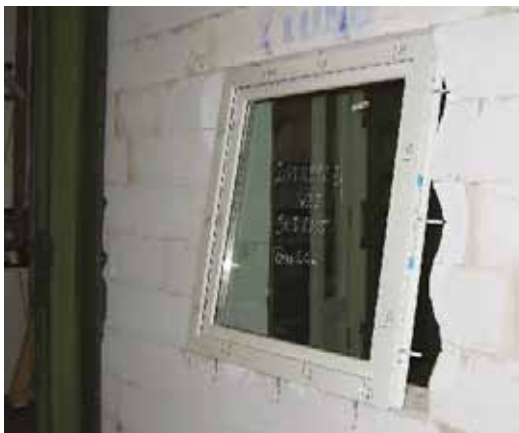
Bild 61. Aus dem Verankerungsgrund gerissenes Fensterelement bei zu geringem Randabstand in Porenbetonmauerwerk
