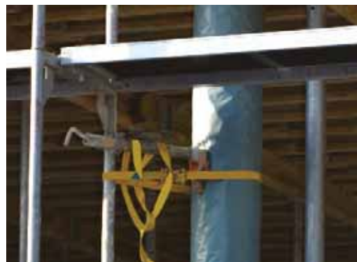
Bild 10. Sicherung eines Fassadengerüsts mittels Spanngurt zur Ladungssicherung
