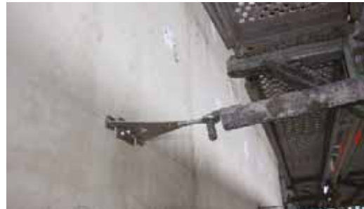
Bild 8. Dauerhafte Einrichtung zur Verankerung von Fassadengerüsten mit Gerüsthalter
