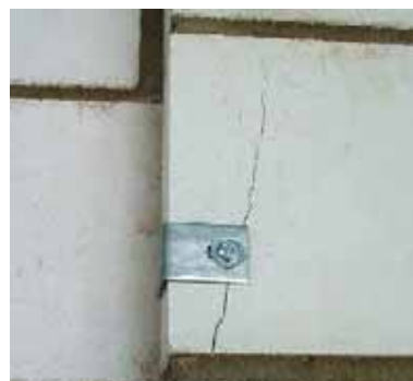
Bild 55. Zu geringer Randabstand eines Kunststoffdübels bei Montage einer Anschweißblase für die Befestigung einer Tür
